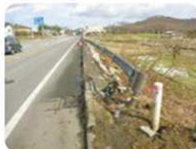
ガードレール・ 標識等の損傷
