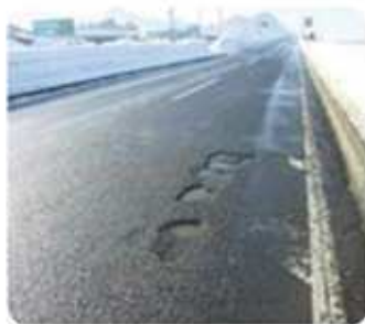
路面の穴ぼこ・ 段差
