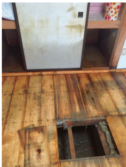
室内の被害状況も撮っておく
