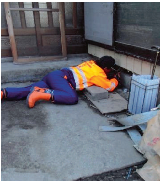
通風口から床下の泥を確認する
