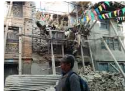
今にも崩れ落ちそうな家(ラリトプール市)。このような状態の建物があちこちにあります。
